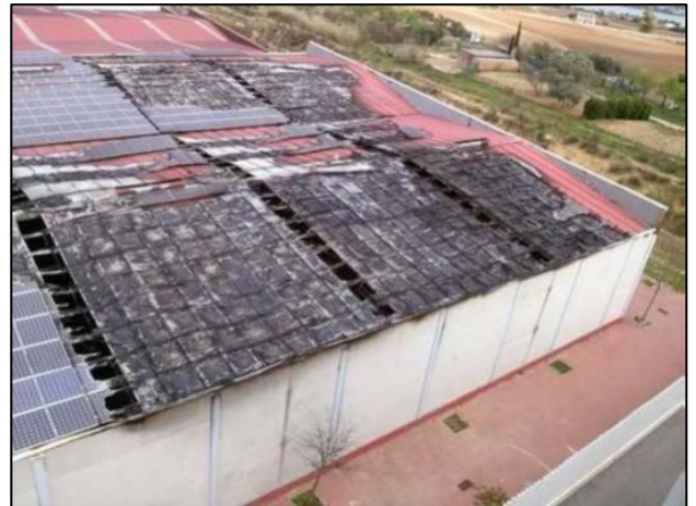
Kuva 4. Aurinkosähköjärjestelmä tulipalon jäljiltä
